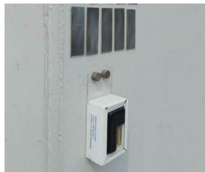
Instalované kupóny a korozní senzor /Installed coupons and corrosion sensors
