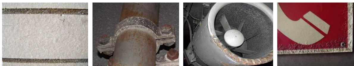
Příklady poškození materiálů a povlaků v tunelech/Examples of materials and coatings degradation in tunnels
